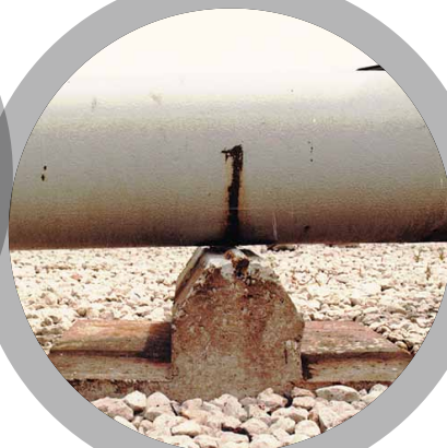
Soporte de tuberías
