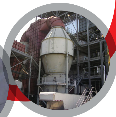
Depuradores de gases
